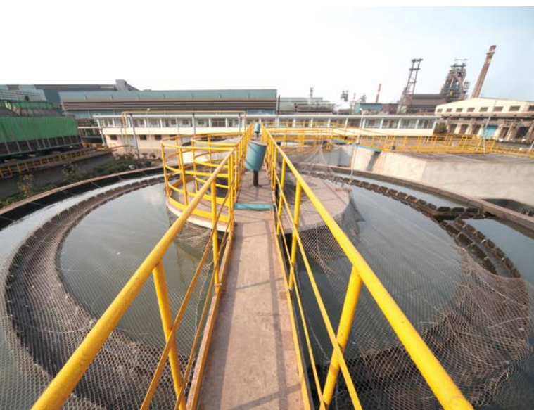
污水处理系统
